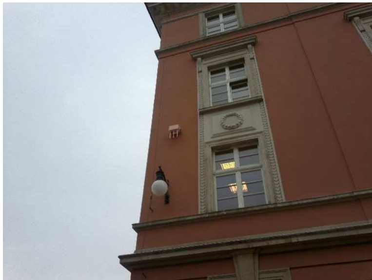
Zdj.1: Przykład instalacji urządzenia na elewacji budynku wraz z maskowaniem
