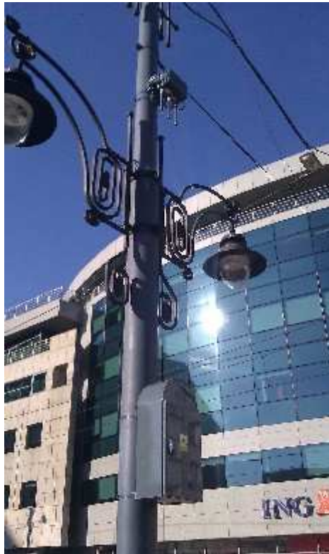
Zdj.2: Przykład instalacji urządzenia na latarni oświetleniowej wraz z maskowaniem
