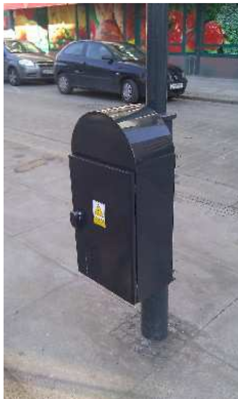
Zdj.3: Przykład instalacji szafki słupowej „stylizowanej”
